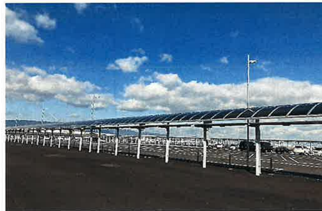
万博会場西ゲートバスターミナルにペロブスカ イトを約250mにわたり設置。 蓄電を行い、夜間LED照明用の電力として利用。
